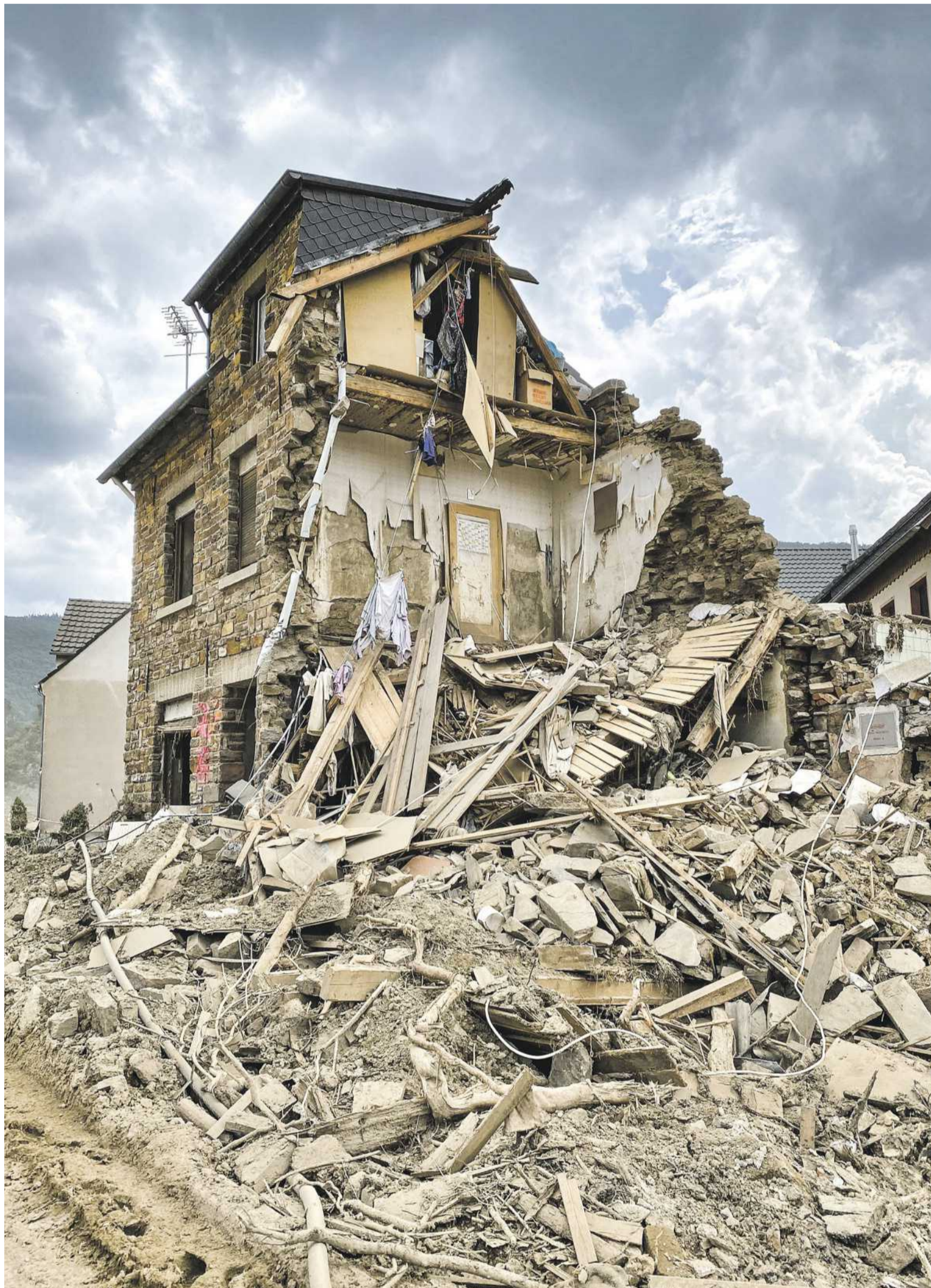
Elementarschaden: Ein vom Hochwasser zerstörtes Haus im rheinland-pfälzischen Altenahr
